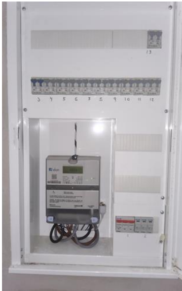
Elektrisk anlegg - [Sikringsskap]
