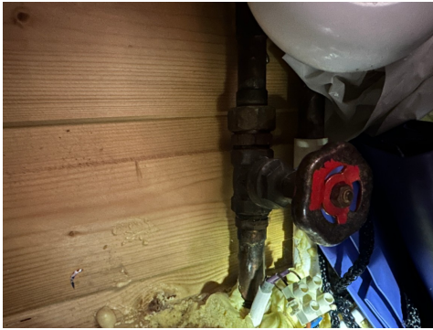
Stoppekran på kjøkken.
