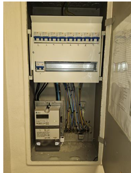
Elektrisk anlegg - [Sikringsskap ]
