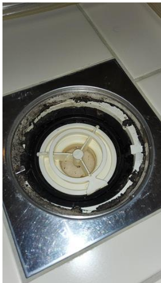
Avløpsrør (ink. sluk) - [Sluk bad]
