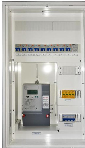
Forenklet vurdering av det elektriske anlegget - [Sikringskap]
