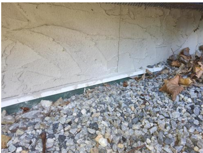
Kommentar - [Riss/sprekk grunnmur tilbygg]
