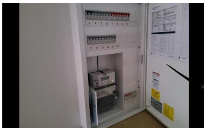
Elektrisk anlegg - [Sikringsskap ]
