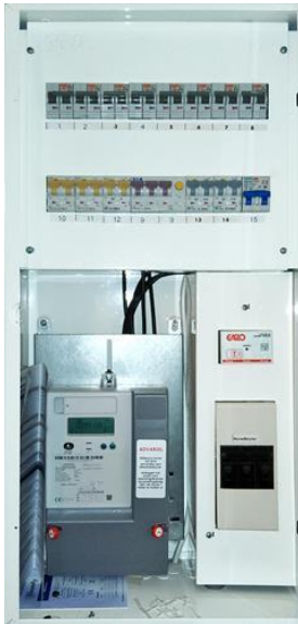
Forenklet vurdering av det elektriske anlegget - [Sikringsskap]
