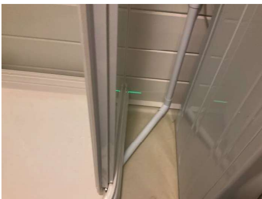
overgang vegg golv, har en mindre oppbrett
