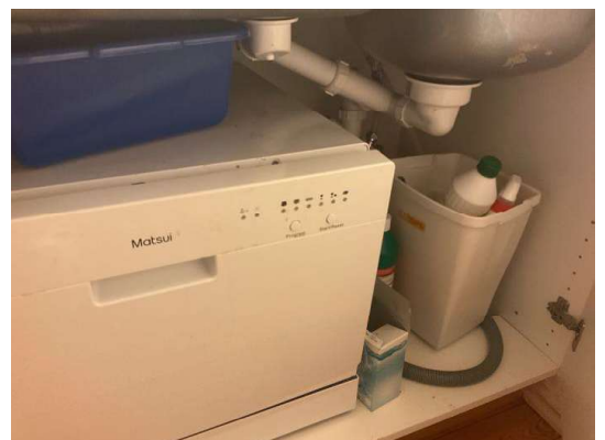
oppvaskmaskin inne i oppvaskbenken
