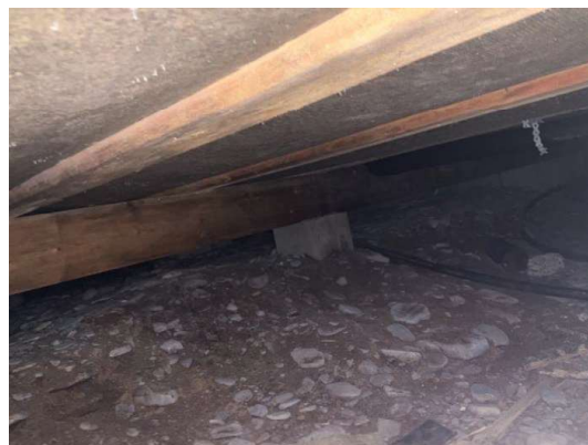
krypkjeller, mangler plast på byggegrunn
