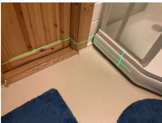
overgang vegg golv, har en mindre oppbrett
