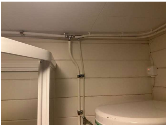
vannledninger av kobber
