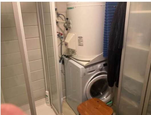
vaskemaskin under varmtvannstank
