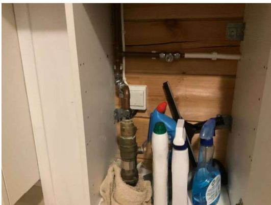
stoppekran i skap på bad vaskerom
