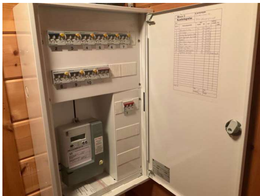
sikringskap med automatsikringer
