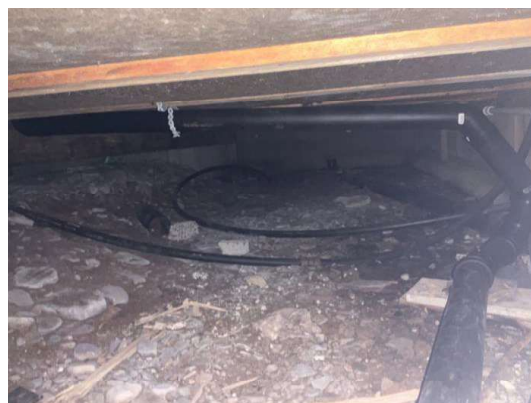
krypkjeller, mangler plast på byggegrunn
