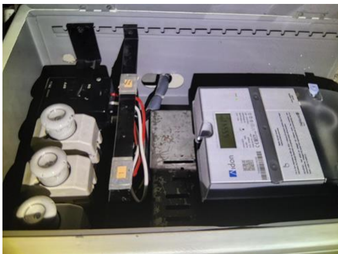
Elektrisk anlegg - [Hovedsikringer]
