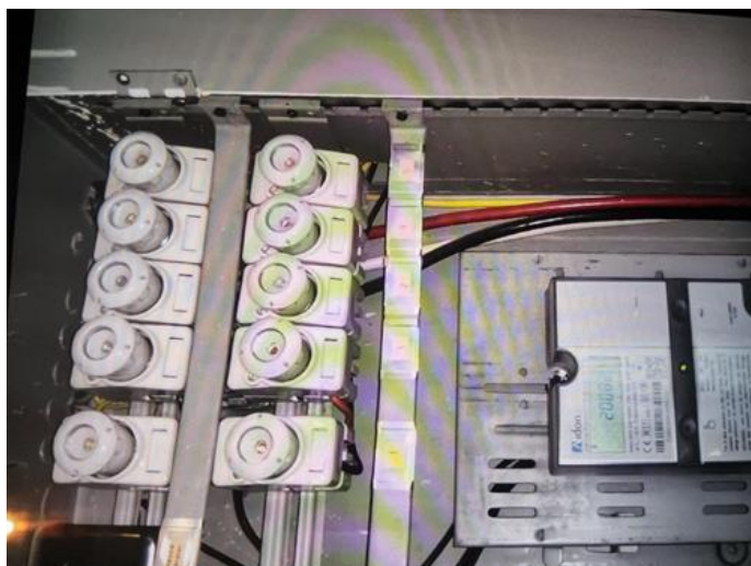
Elektrisk anlegg - [Sikringer]
