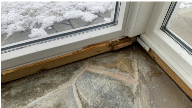
Lekkasjer ved vinduer og skyvedør i tilbygget del av stue.
