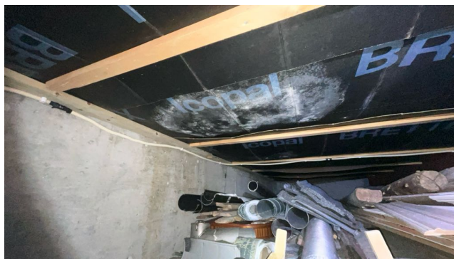
Viser fuktmerker en plass.
