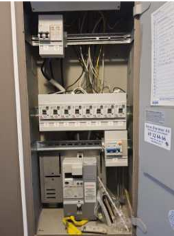
Elektrisk anlegg - [Sikringsskap]
