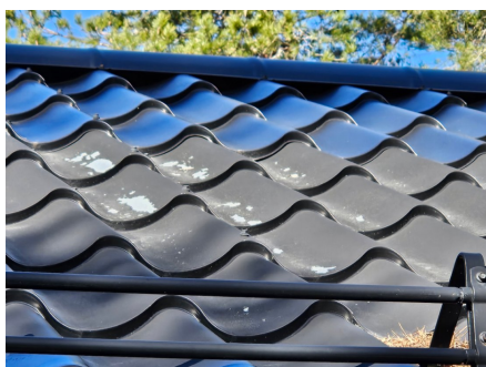
Noe malings flassing på taket.
