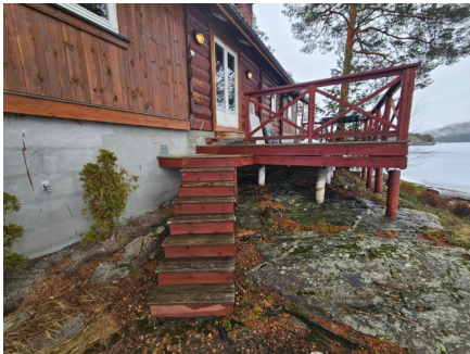
Trappen mangler rekkverk
