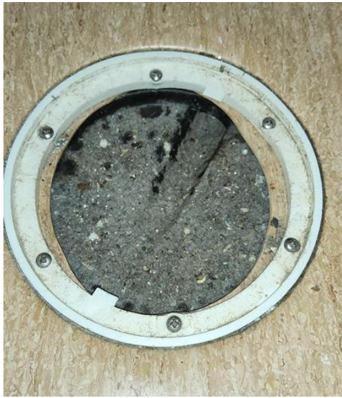
Avløpsrør (ink. sluk) - [Sluk bad]
