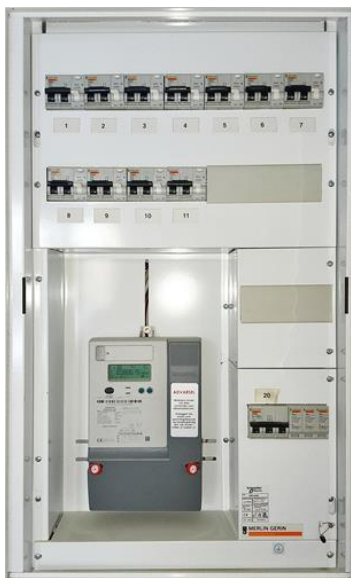
Forenklet vurdering av det elektriske anlegget - [Sikringskap]
