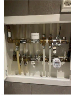
Vannrør (Sjekkpunkter utover det som er inkludert i andre rom) - [Fordelerskap for rør-i-rør]
