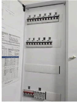
Elektrisk anlegg - [Sikringskap]
