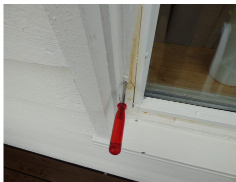
Råte i vindu mot sørvest
