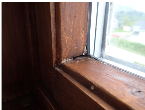
Nedre del av vindu løsner/siger
