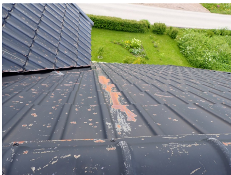
Slitasje/rust i takplater
