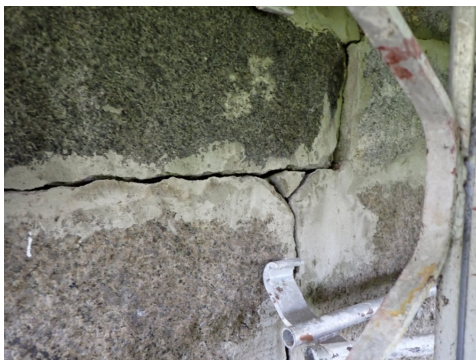
Sprekker i steinmur
