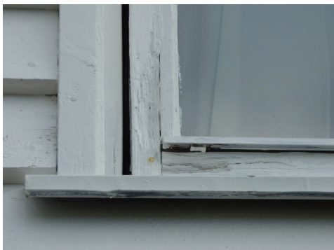
Utvendig råte i vindu mot vest
