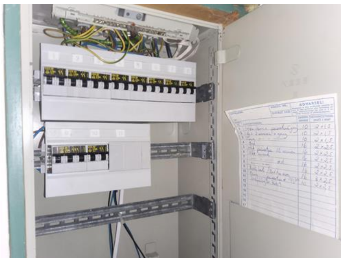
Beskrivelse - [Sikringsskap i kjellerstue]
