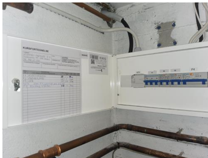
Beskrivelse - [Sikringsskap i teknisk rom]
