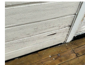
Bordkledning og omramminger med råteskader.
