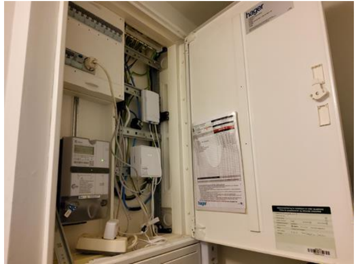
Kommentar - [Sikringskap plassert i bod.]
