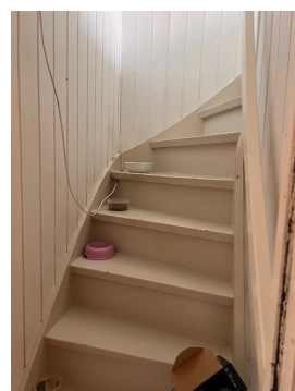
Trapp mangler håndløper på vegg.
