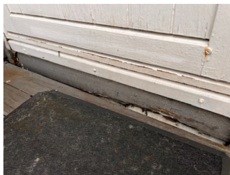
Råteskader i kledning under balkong dør og langs terrasse.
