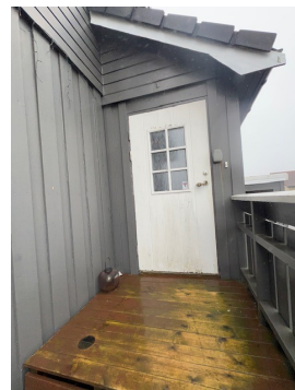
Slitasje/Fuktskader på hovedinngangsdør
