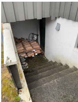
Kjellertrapp mangler håndløper på sider trapp.
