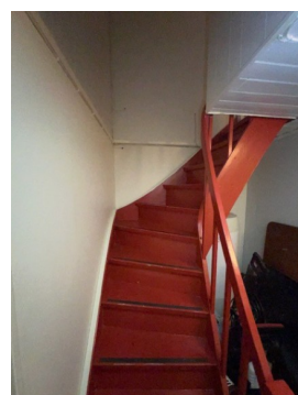
Trapp mangler håndløper på vegg.
