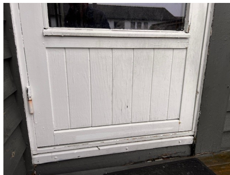
Fuktskader i balkong dør
