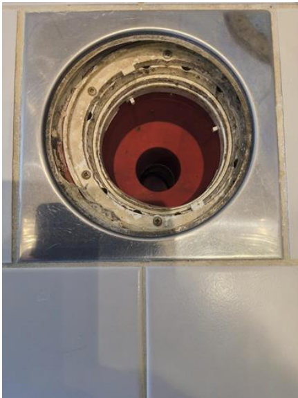
Slukets tilkomstmulighet for rengjøring - [Sluket i dusjsonen ]
