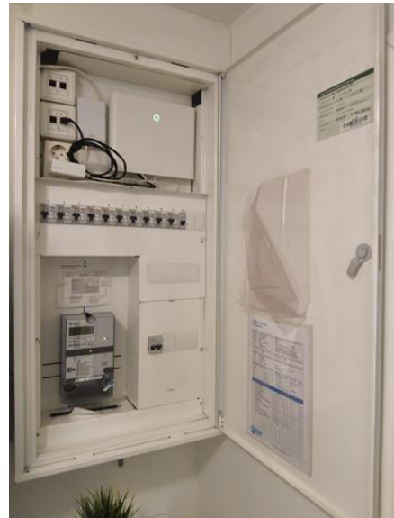
Elektrisk anlegg - [Sikringskap ]
