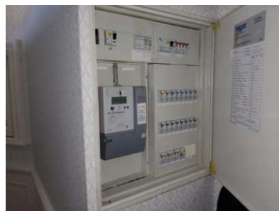
Elektrisk anlegg - [Sikringsskap entré]
