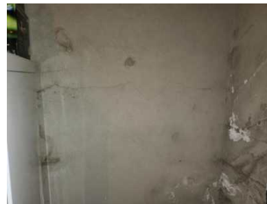
Kommentar - [Riss/sprekk i teknisk rom.]
