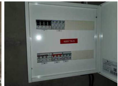
Elektrisk anlegg - [Sikringsskap teknisk rom ]
