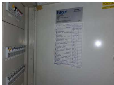
Elektrisk anlegg - [Kursoversikt entré]
