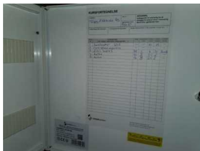
Elektrisk anlegg - [Kursfortegnelse teknisk rom.]
