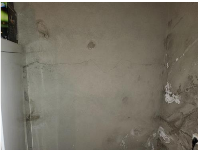
Kommentar - [Riss/sprekk i teknisk rom.]
