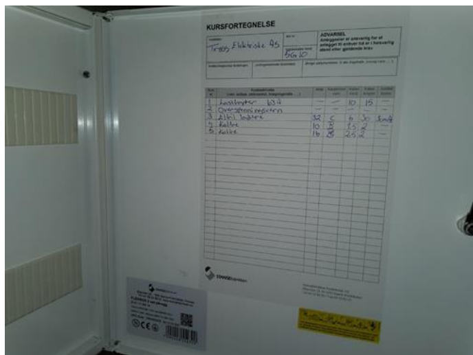
Elektrisk anlegg - [Kursfortegnelse teknisk rom.]
