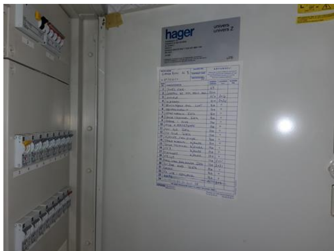
Elektrisk anlegg - [Kursoversikt entré]
