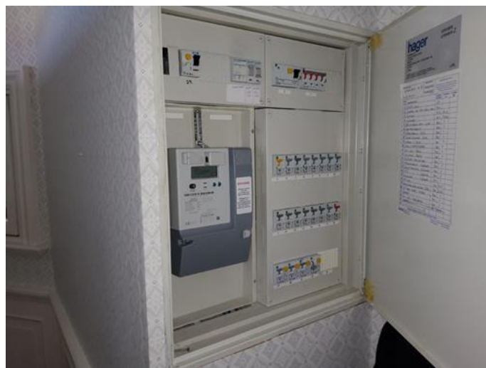
Elektrisk anlegg - [Sikringsskap entré]
