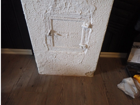
Sotluke i u.etg, mangler ubrennbar plate under
