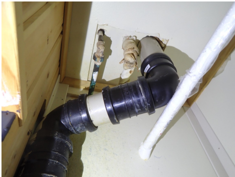
Drypplekkasje fra rør i garderobe
