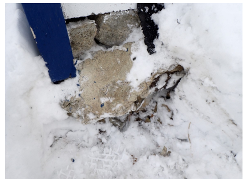
Utglijning under støpt dekke ved hjørne mot sørøst
