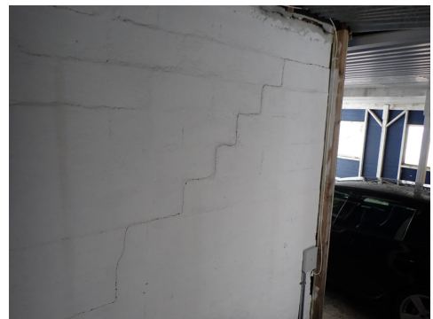
Sprekker/riss ved hjørne mot sørvest
