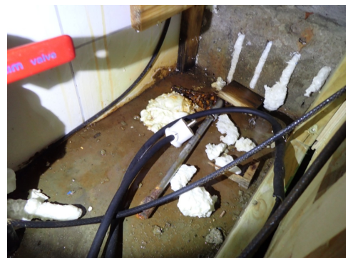
Vann på gulv under vannpumpen
