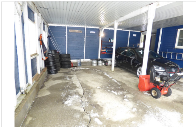
Carport, sprekke i dekke
