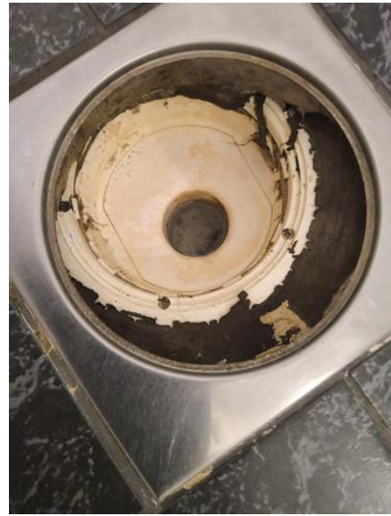
Slukets tilkomstmulighet for rengjøring - [Sluket i dusjsonen]
