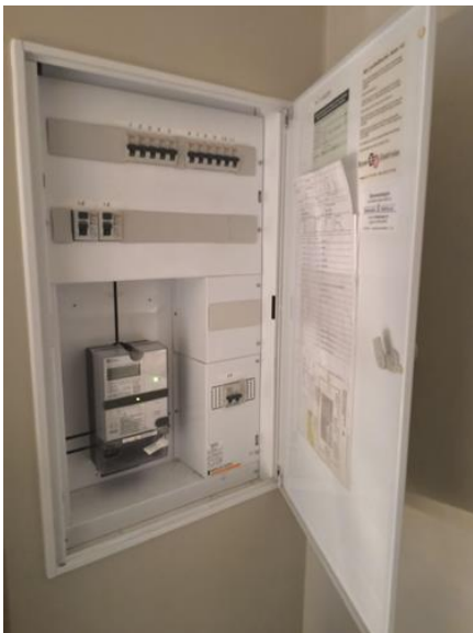
Elektrisk anlegg - [Sikringskap]
