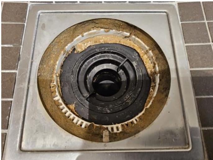
Avløpsrør (ink. sluk) - [Sluk baderom]
