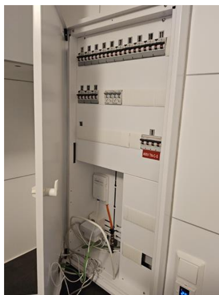
Elektrisk anlegg - [Sikringsskap]
