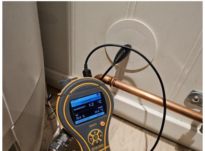
Fukt i tilliggende konstruksjoner - [Fuktmåling baderom]
