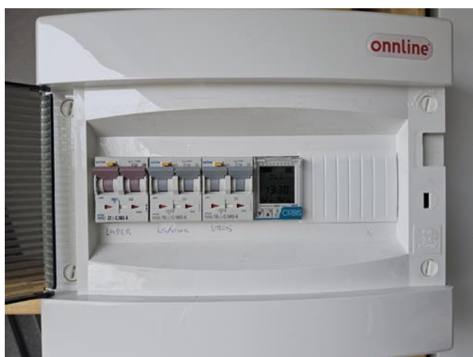
Elektrisk anlegg - [Sikringsskap garasje]
