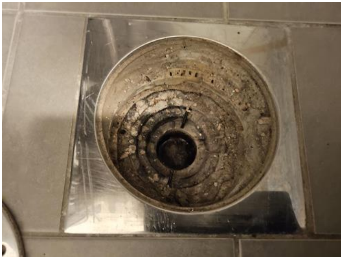
Avløpsrør (ink. sluk) - [Sluk vaskerom]
