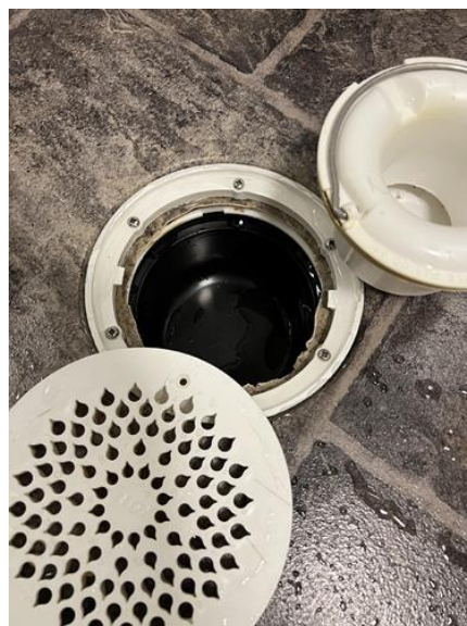
Avløpsrør (ink. sluk) - [Sluk bad 1. etasje]
