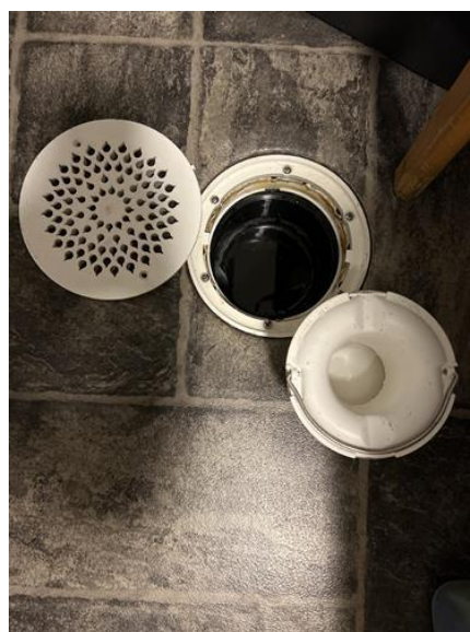
Avløpsrør (ink. sluk) - [Sluk vaskerom]
