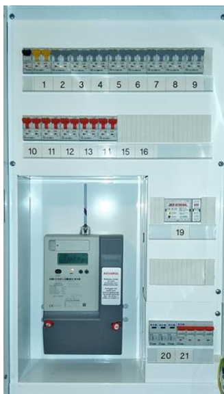
Forenklet vurdering av det elektriske anlegget - [Sikringskap]
