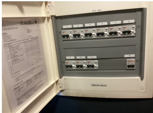
Bilde av sikringskap
