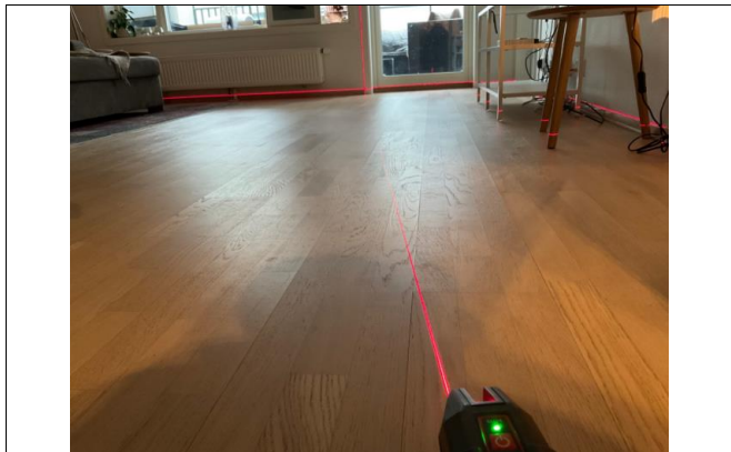
Nivellering stue, ingen registrerte avvik
