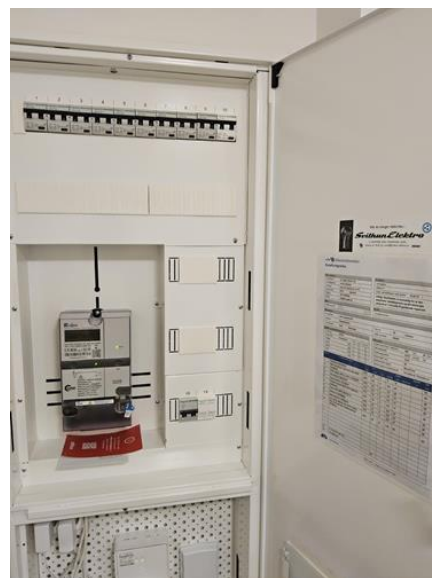
Elektrisk anlegg - [El-skap.]
