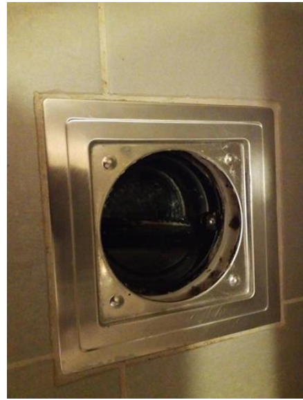
Avløpsrør (ink. sluk) - [Sluk bad]
