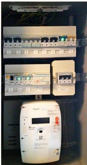
Forenklet vurdering av det elektriske anlegget - [Sikringskap]
