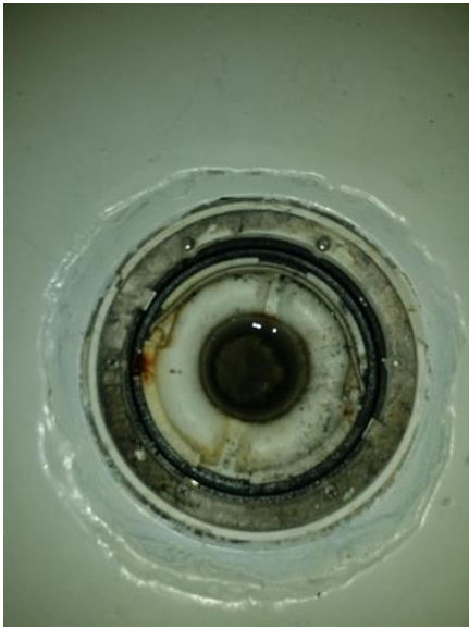
Avløpsrør (ink. sluk) - [Sluk vaskekjeller]
