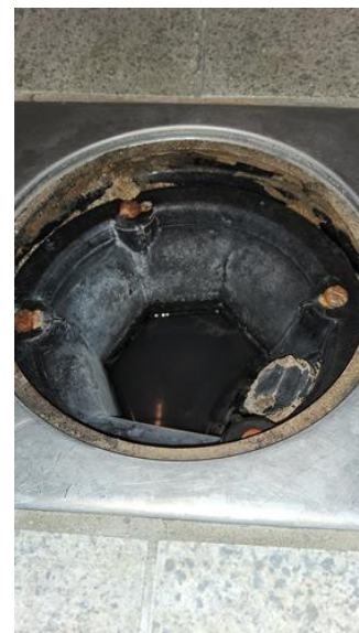
Helhetsvurdering - [Sluk bad underetasje]
