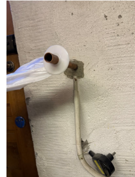
Utekran ved kjellertrapp er ikke tilkoblet.
