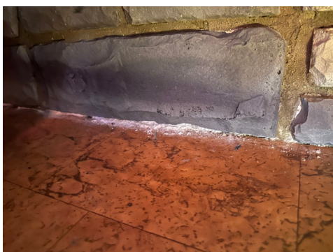
Saltutslag i overgang vegg/gulv i kjellerstue.
