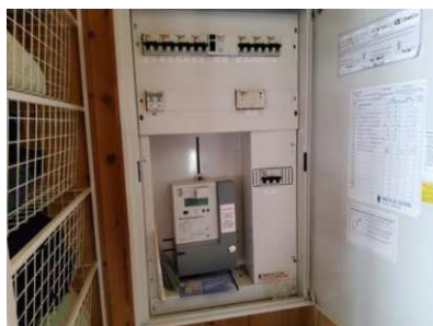
Elektrisk anlegg - [Sikringsskap 2. etg.]
