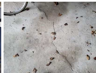
Kommentar - [Sprekk i golv, garasje.]
