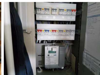
Elektrisk anlegg - [Sikringsskap 1. etg.]
