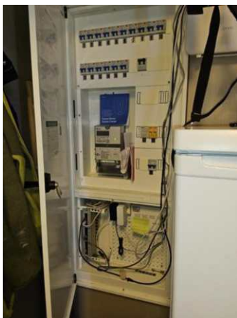
Elektrisk anlegg - [Sikringsskap]
