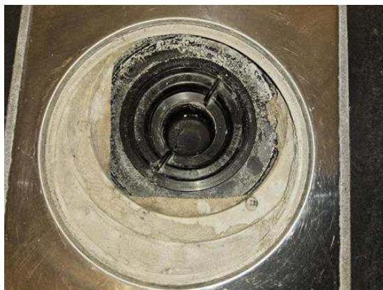
Våtrom - [Sluk bad 1.etg dusjsone.]
