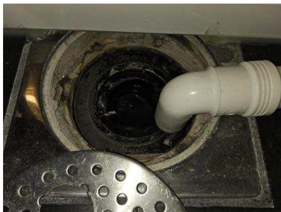
Våtrom - [Sluk bad 1.etg.]
