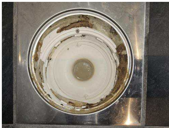
Våtrom - [Sluk bad 2.etg (dusjkabinett)]
