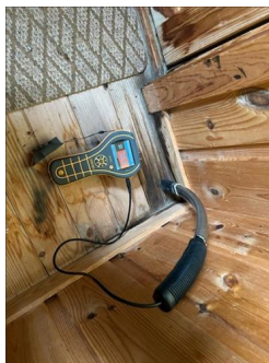
Overflate gulv - Fuktmåling i entre
