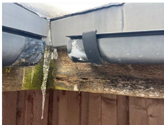
Helhetsvurdering - Eksempel på skader
