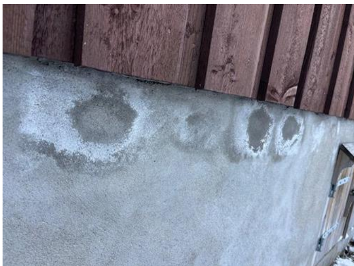
Drenering - [Fuktmerker på grunnmur]
