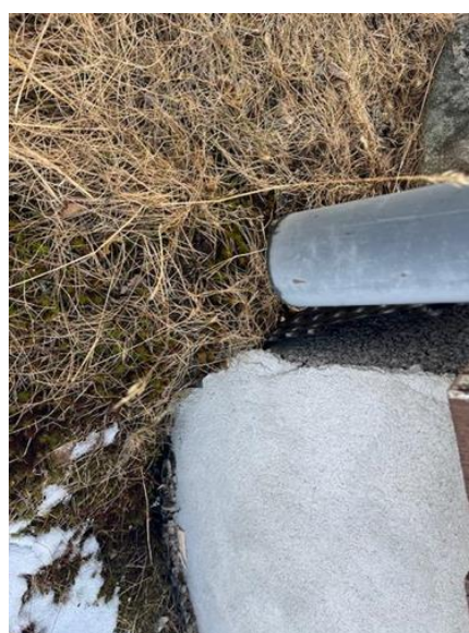
Drenering - [Mangelfull bortledning av takvann]
