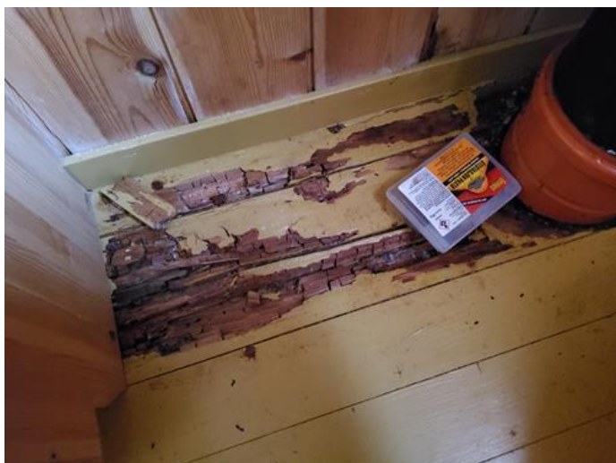
Overflater gulv - [Råteskader gulv på toalettrom]
