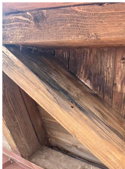
Kommentar - [Råteskader i undertak]
