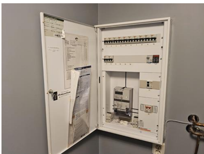
Elektrisk anlegg - [Sikringsskap. ]
