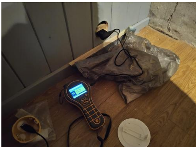
Våtrom - [Fuktmåling tilstøtende rom.]
