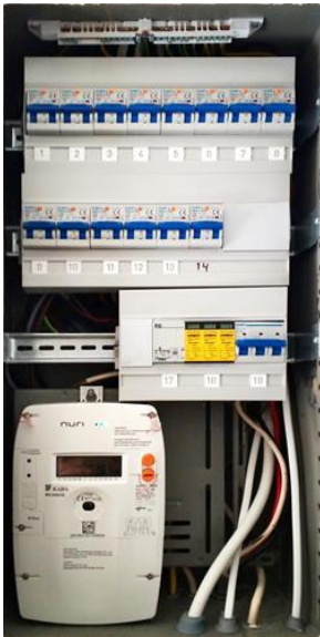
Forenklet vurdering av det elektriske anlegget - [Sikringskap]
