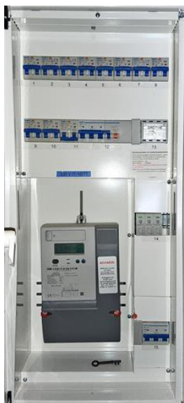
Forenklet vurdering av det elektriske anlegget - [Sikringsskap]
