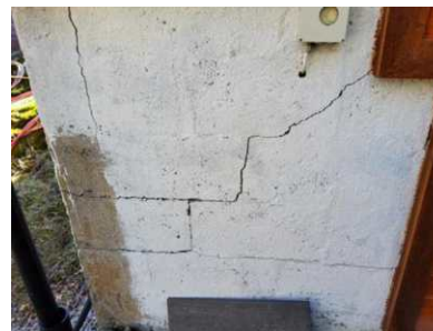
Grunnmur, fundamenter - [Sprekk i grunnmur.]
