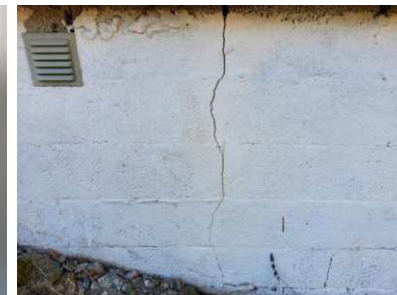
Grunnmur, fundamenter - [Sprekk i grunnmur.]
