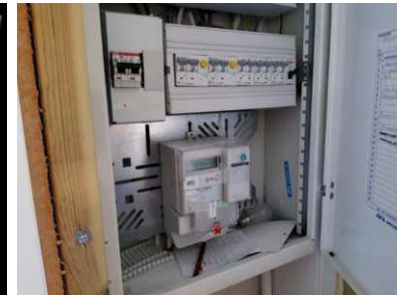
Elektrisk anlegg - [Sikringsskap]
