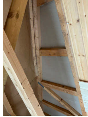
Fuktmerker i undertak.
