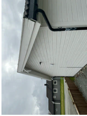
Slitasje på vindskjær.
