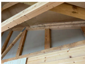
Fuktmerker i undertak.
