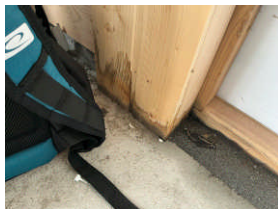
Fuktmerker i treverk ved dør.
