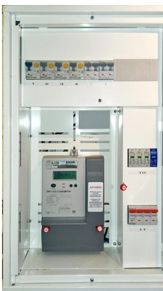
Forenklet vurdering av det elektriske anlegget - [Sikringskap]
