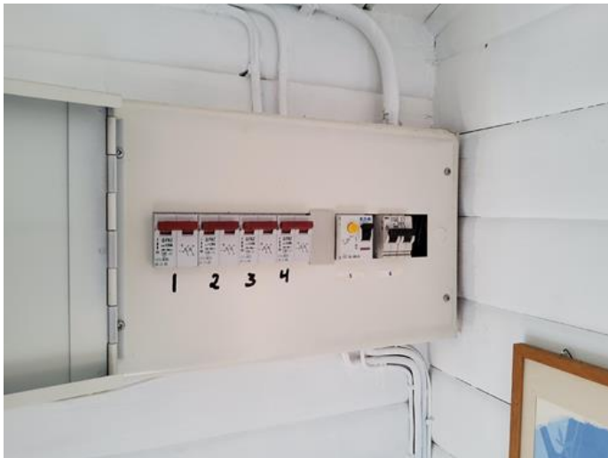
Elektrisk anlegg - [Sikringsskap]
