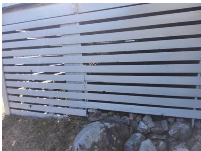
Balkonger, terrasser, veranda etc - [Spilekledning under balkong.]
