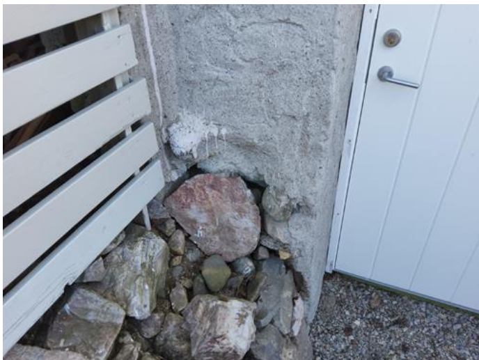
Grunnmur, fundamenter - [Tegn til løse steiner utvendig på grunnmur ved inngang til kjeller.]
