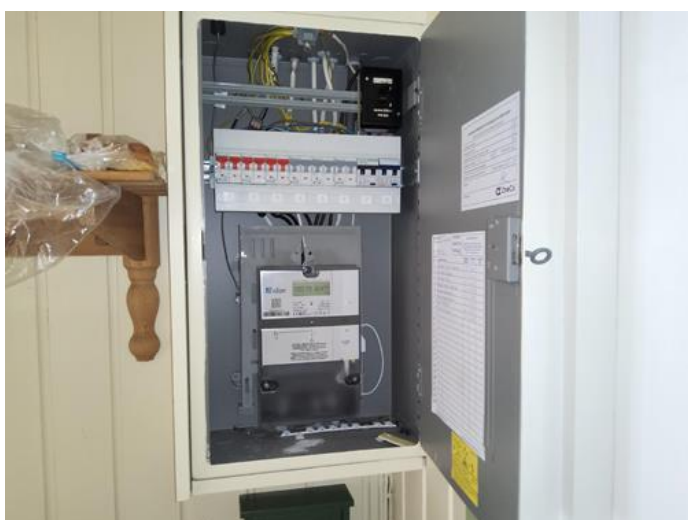
Elektrisk anlegg - [Sikringsskap. ]
