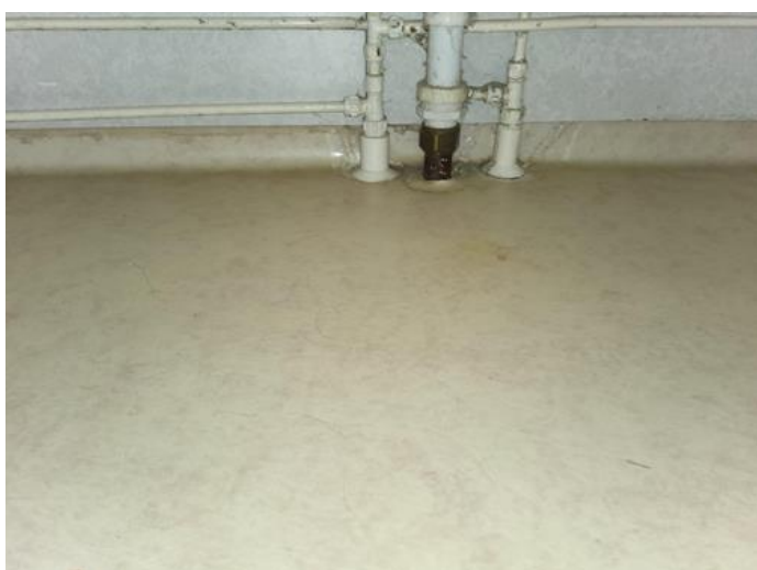
Helhetsvurdering - [Rørgjennomføringer i gulv på bad]
