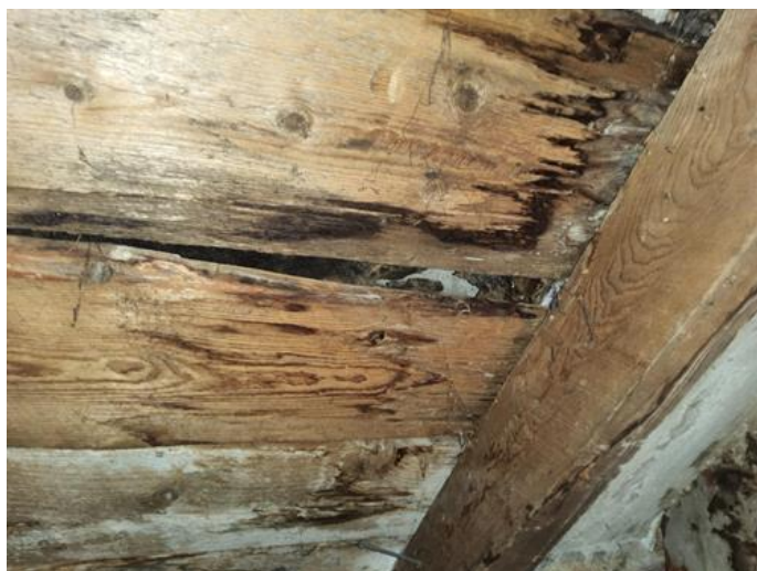
Annet - [Område ved pipe på loft med hull i undertak. ]
