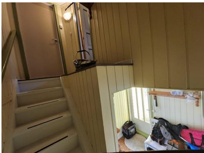
Innvendige trapper - [Kant i trapp til 2.etasje med mangelfull sikring. ]
