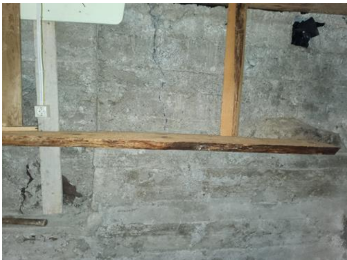
Overflater vegger - [Sprekk i yttervegg i kjeller]
