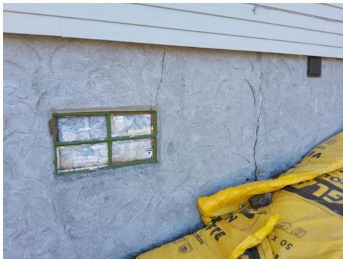
Grunnmur, fundamenter - [Sprekker i grunnmur gavel mot nord.]
