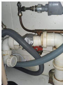
Innvendig stoppekran - Stoppekran
