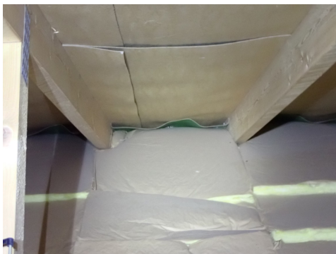
Eksempel på at pappskuffer er presset opp i undertak
