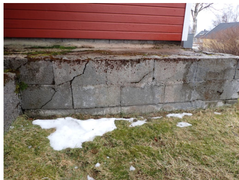
Oppsprekking i mur
