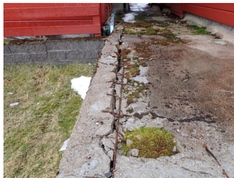
Oppsprekking mellom mur og betongplate
