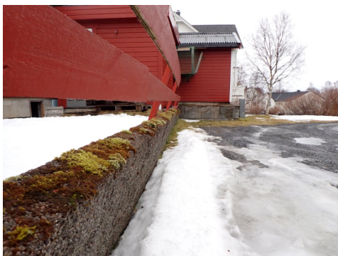
Støttemur er presset ut, lavt rekkverk
