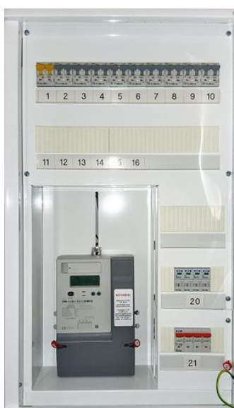
Forenklet vurdering av det elektriske anlegget - [Sikringskap]
