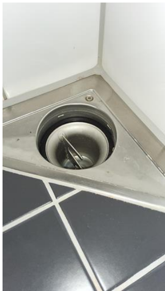
Avløpsrør (ink. sluk) - [Sluk bad]
